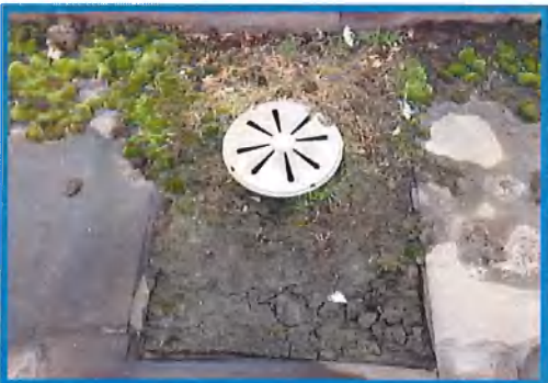
Sprake van veel vervuiling tpv pluvia
