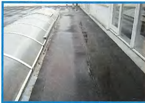
Mos en algen verwijderd
