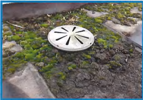
Sprake van veel vervuiling tpv pluvia
