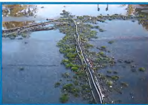
Veel mosgroei door kabels
